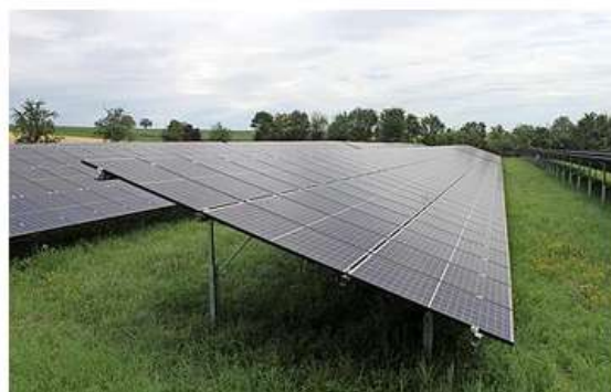
Photovoltaik in Grünzügen stellt ein immer größer werdendes Problem dar. Der Regionalverband will dieser Entwicklung gegensteuern. Foto: Archiv/Hettich
